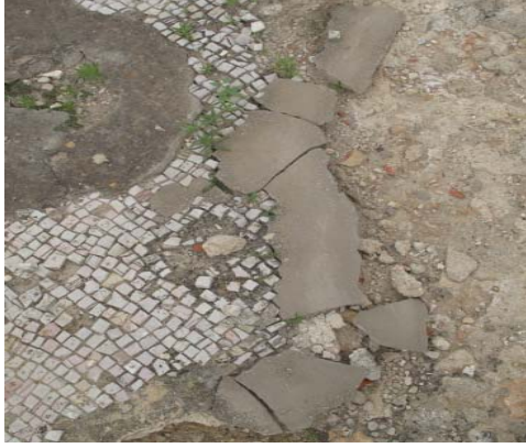
صورة ١١: توضيح الترميم الخاطئ للفسيفساء الأرضية باستخدام ملاط
