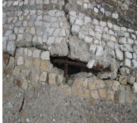
صورة ١٠: توضيح الترميم الخاطئ للفسيفساء الأرضية عن طريق استخدام دعائم حديدية قابلة للصدأ
