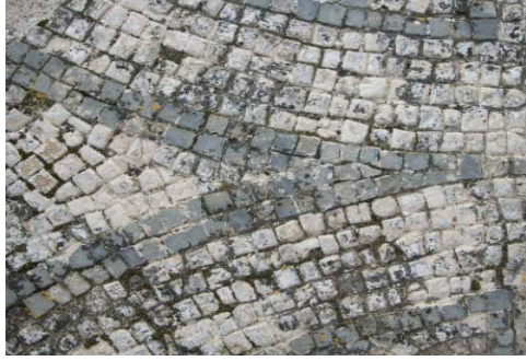
صورة (٩) : توضح إصابة الفسيفساء الأرضية بالطحالب
