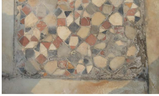
صورة ١٢ : توضح مظاهر التلف الناتجة عن الترميم الخاطئ
